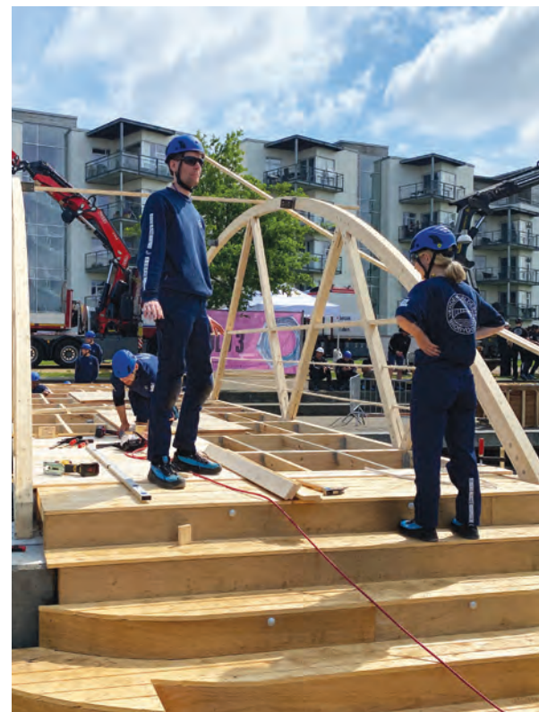
Hold 3s vinderbro
